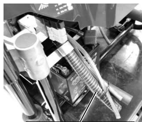
（真空泵排水口）
