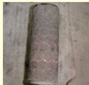
真空ポンプストレーナー ゴミ詰まりによる吸水不能
